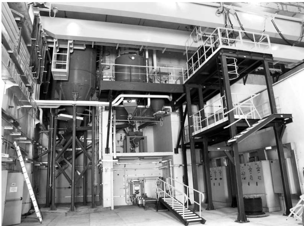
Рис. 10.1.2. Узел переработки жидких отходов ЗПЖРО
